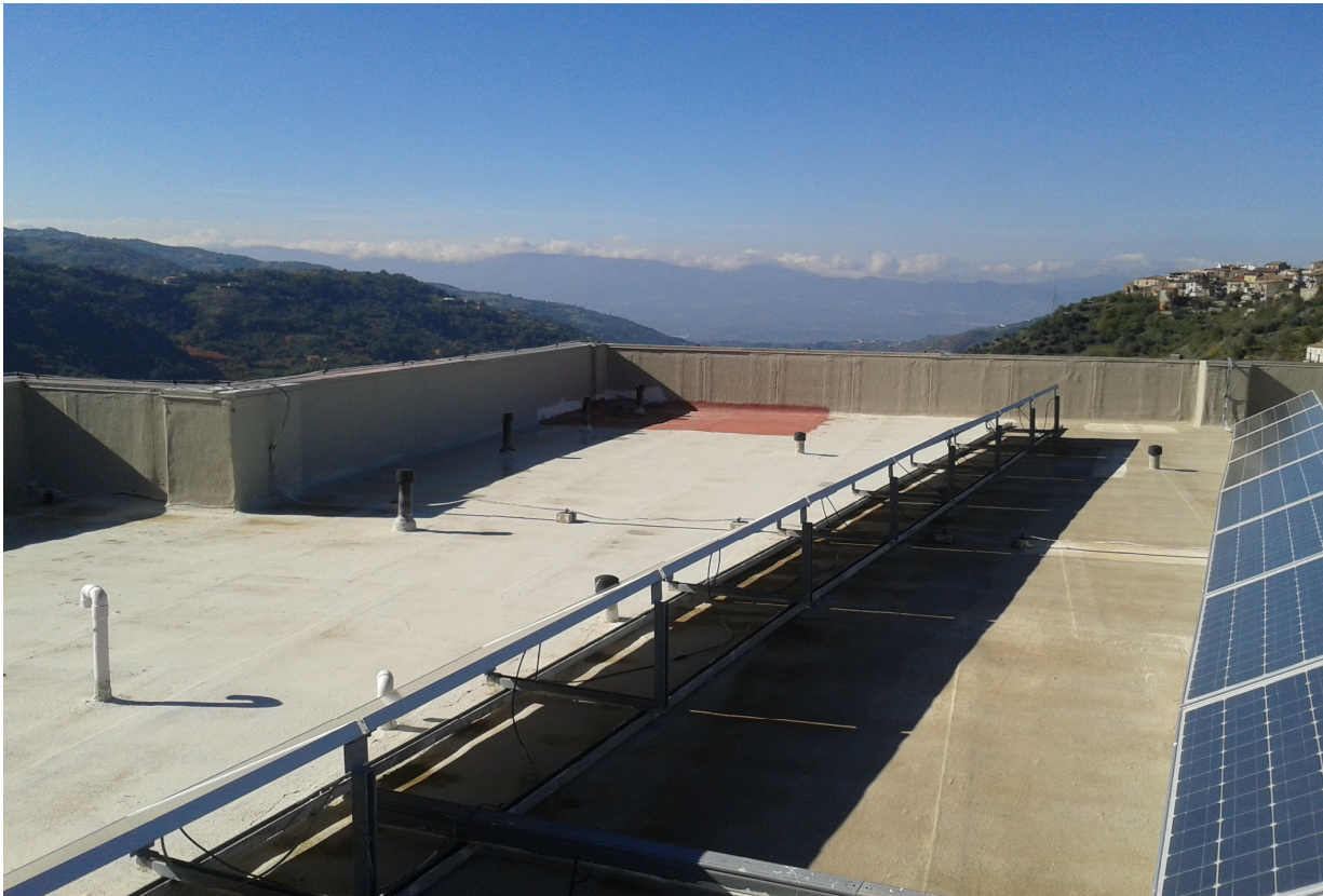
Copertura esistente con guaina bituminosa ricoperta da resina, con vari rattoppi e presenza di pannelli fotovoltaici
