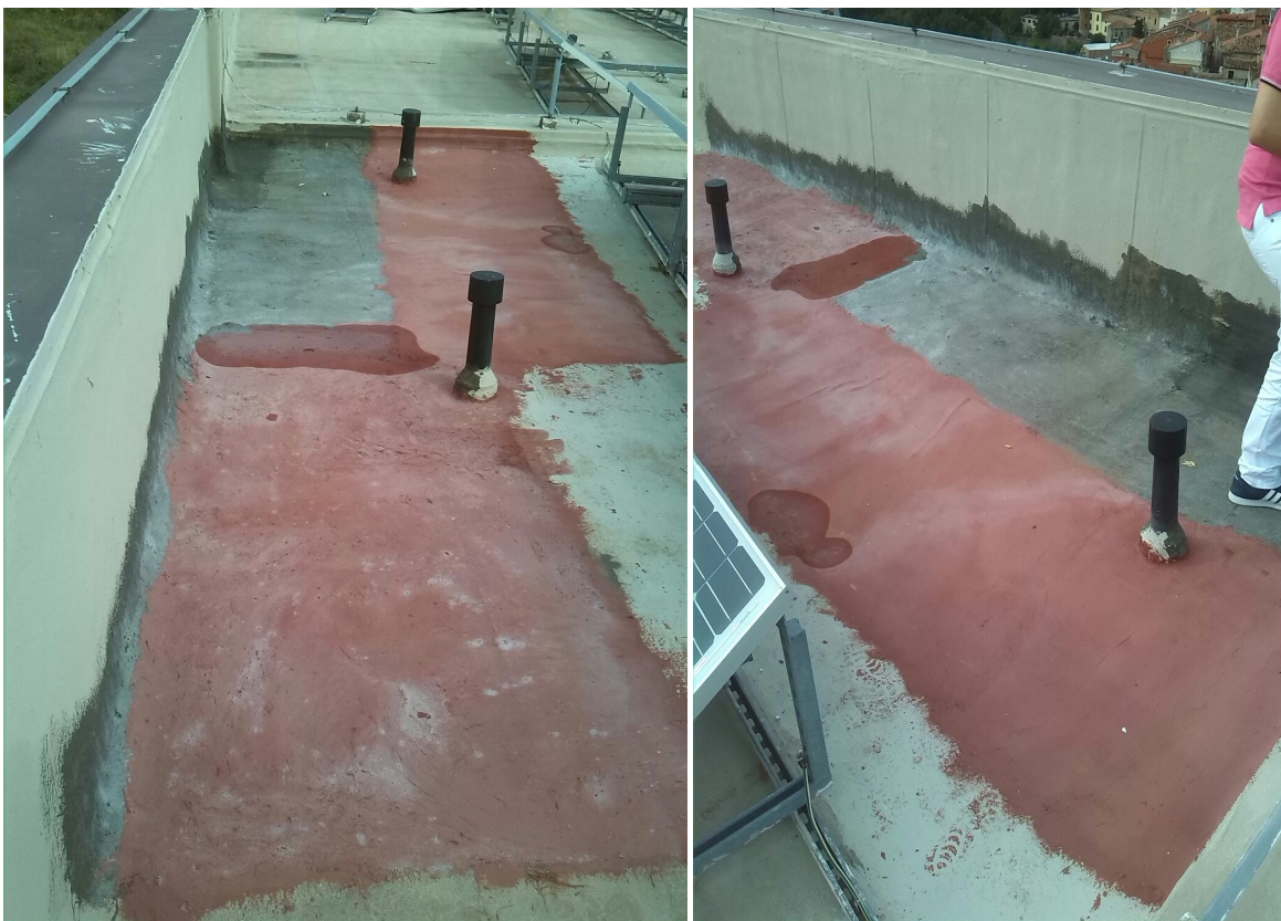
Copertura esistente con guaina bituminosa ricoperta da resina, con vari rattoppi e presenza di pannelli fotovoltaici
