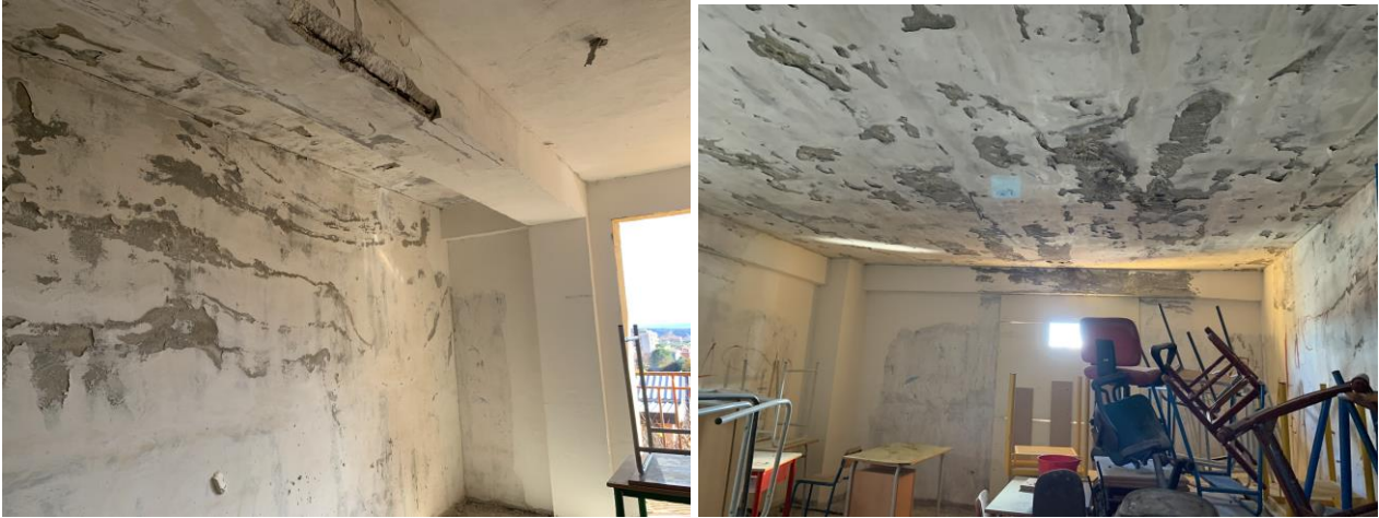
Foto 3-4: vista del degrado interno
